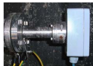
Fotodokumentation einer Messstelle
