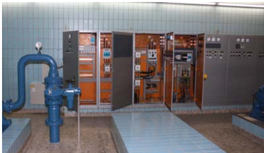
Vorhandener Schalt- und Steuerschrank
