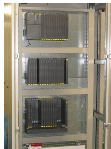
Beispiel-Automatisierung (SPS) S7-400
