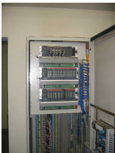
Vorhandene (alte) Automatisierung (SPS)
