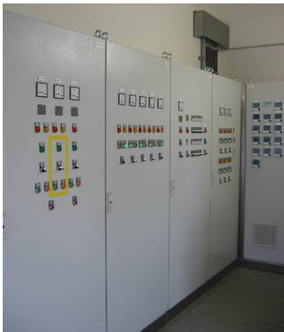
Schalt- und Steuerschrank
