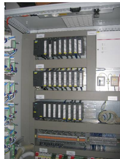
Automatisierung (SPS) S7-300
