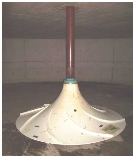
Vertikalrührwerk im RÜB
