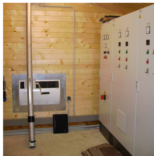
Schaltanlage im Blockhaus
