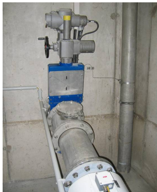
Mess- und Drosselstrecke
