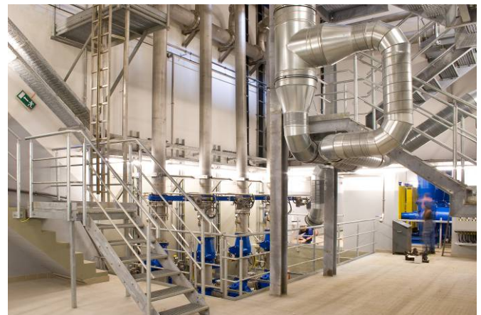
Schmutzwasserpumpwerk mit Lüftungsanlage
