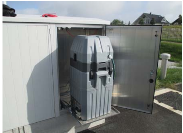
Schaltschrank mit Probennehmer
