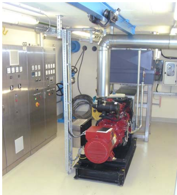
neue Schaltanlage und Netzersatzanlage
