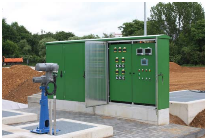
Schaltanlage im Alu-Freiluftschrank
