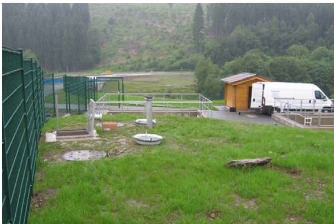
SW-Drosselschacht, BÜ und RKB (v. l. n. r.)
