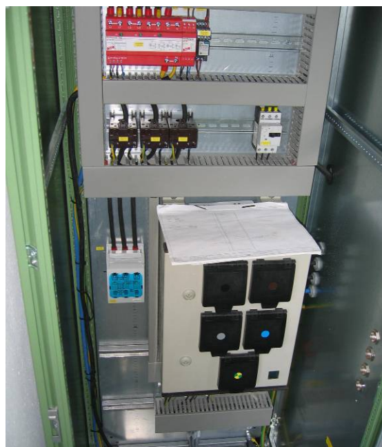
Notstromspeisung im Schaltschrank
