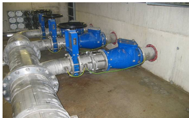
Druckleitungen mit Armaturen der Entleerungs- und Drosselpumpen
