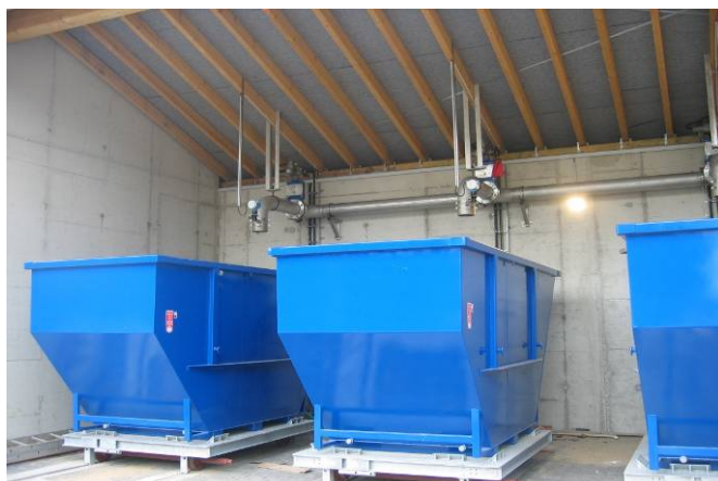
Entwässerungscontainer mit Beschickungsleitungen
