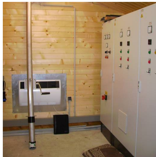
Schaltanlage im Blockhaus
