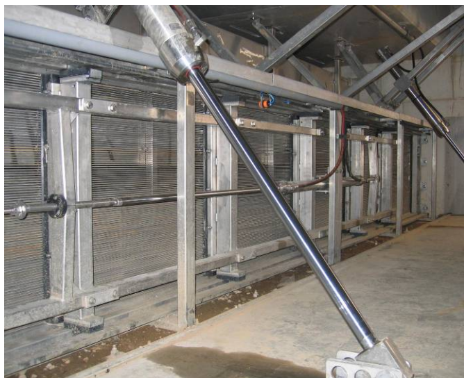
Siebrechenanlage mit offener Entlastungsklappe
