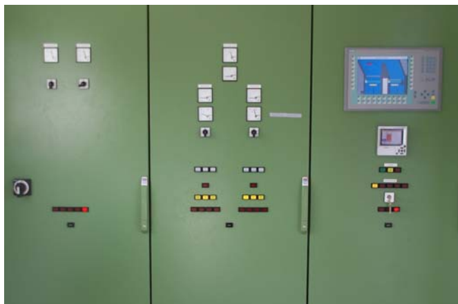
Schaltschrank im Betriebsgebäude
