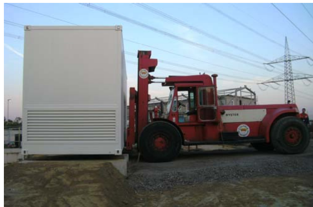
Aufstellung Container unter der Hochspannung
