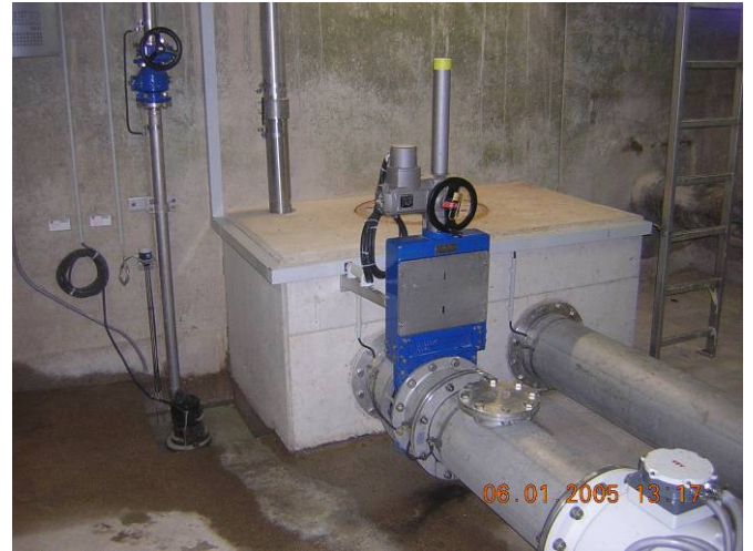
neue Absperr- und Drosseleinrichtungen
