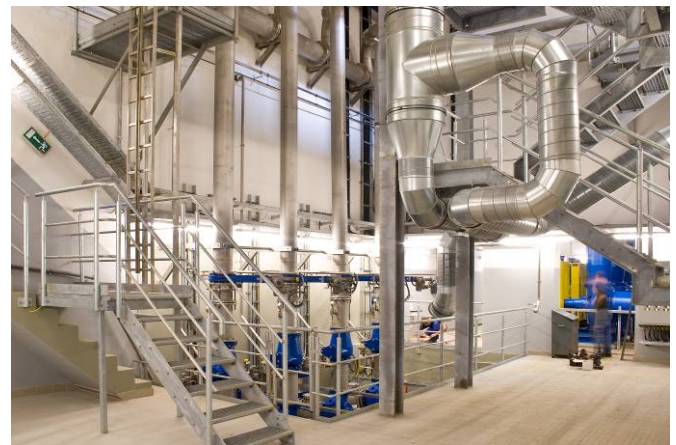
Schmutzwasserpumpwerk mit Lüftungsanlage
