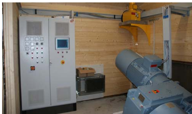
Betriebsgebäude mit Schalt- und Steuerschrank, Hydraulikaggregat und Abtriebseinheit der Wasserkraftschnecke
